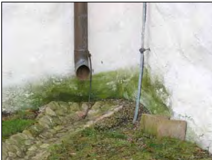
Bristfällig vattenavledning har skadat och missfärgat putsen i hörnet mellan kor och sakristia.
