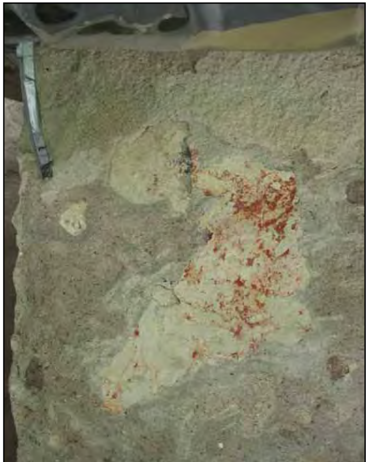
Aldre puts-skikt på södra strävpelaren med tydliga stänk från röd slamfärg. Dylika stänk kunde även påvisas under remstycket på korets norra vägg. Är det spår av rödfärgning av takspån eller remstycke?
