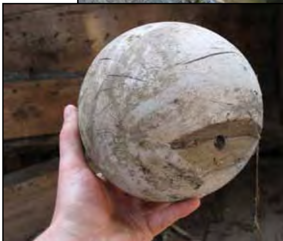
Balustradens svarvade klot byttes ut 1998 mot nya som svarvats ur ett stycke furu och fått små blyhättor för vattenavledningen. Likväl har några spruckit sönder, huvudsakligen till följd av att virket ej var tillräckligt torrt. Nedre fotografiet visar ett av de tidigare kloten som förvaras i lanterninen, de består av åtta hopsatta kärnstycken som svarvats och tycks ha stått emot väder och vind bättre än de nuvarande.
