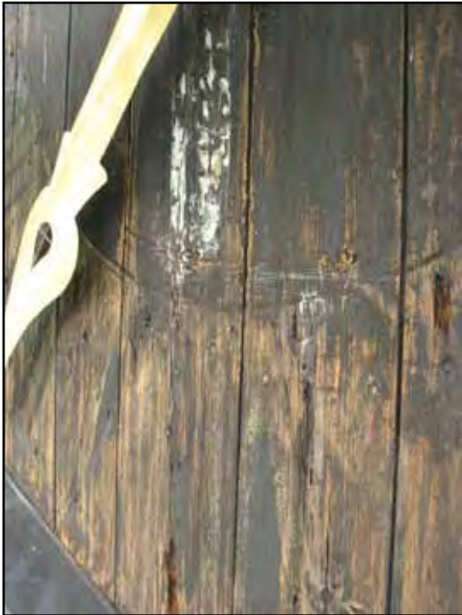
Skador på den västra urtavlan, tidigare lagade med plastic padding. Notera att nuvarande plåtsiffror är demonterade och att det syns tydliga spår av att originalsiffrorna var målade direkt på träet.
