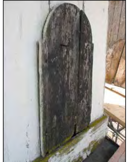
Skadad lucka och fotlist på lanterninens nordöstra sida, Wrangelska gravkoret.
