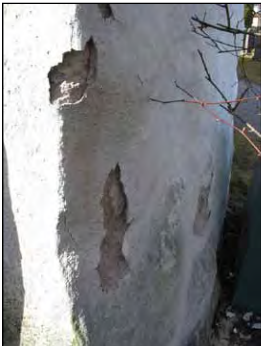
Putssläpp och omfattande bom på norra strävpelarens KC-puts.
