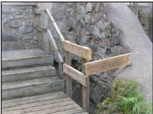
Mellanväggens nordsida förutsätter omfattande om-murning. Detta arbete hanns inte med under 2010 och avser utföras under nästa år. Ett tillfälligt träräcke sattes upp.
