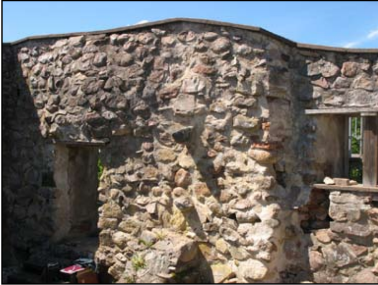
Insidan av västmuren. Hela inre skalmuren över porten var på väg att kalva ut.
