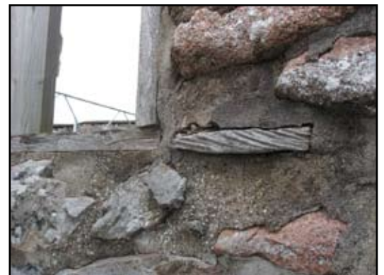
Rest av ursprunglig fönsterbänk på östfasaden.
